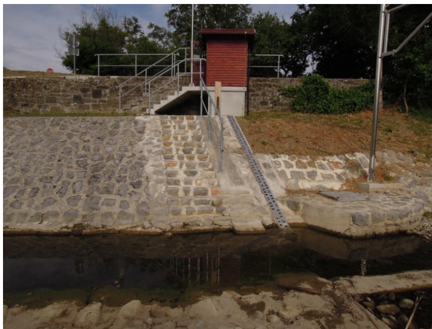
Slika 5: Novo avtomatsko merilno mesto Trpčane na Reki (foto: Marko Burger)
