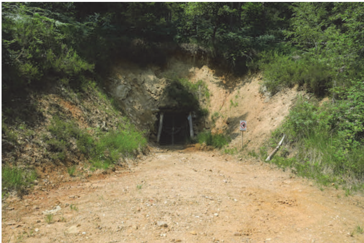
Slika 38: Nezavarovana, strma brežina nad rovom 304 (E)
