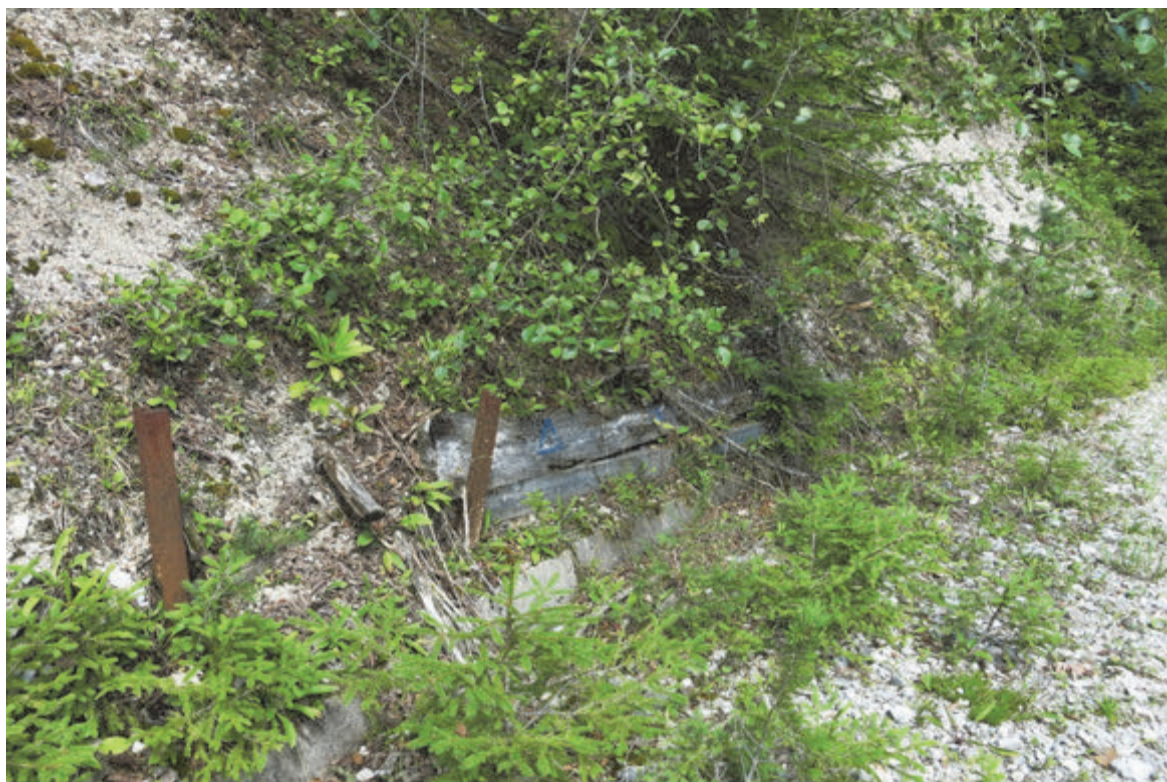
Slika 27: Vzhodni del: dotrajana protierozijska zaščita in zasute kanalete v spodnjem delu odlagališča
