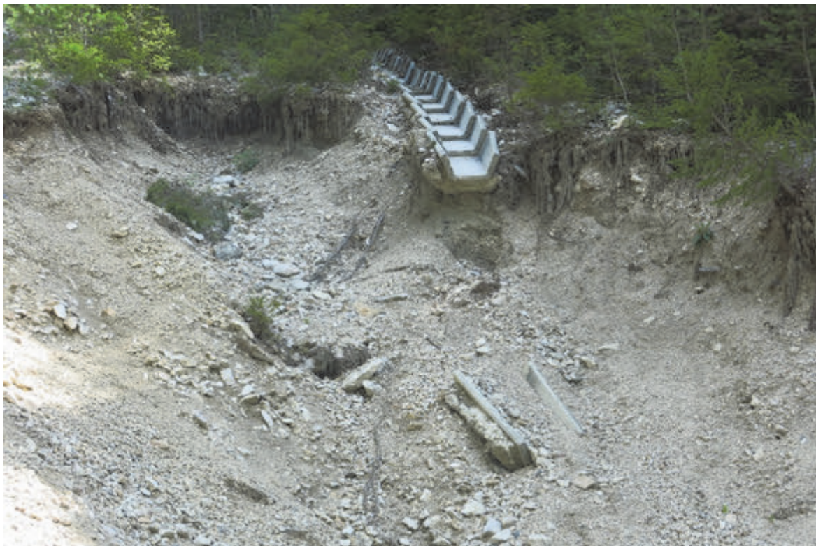
Slika 14: Odtrgane betonske kanalete v srednjem delu odlagališča K-26/18
