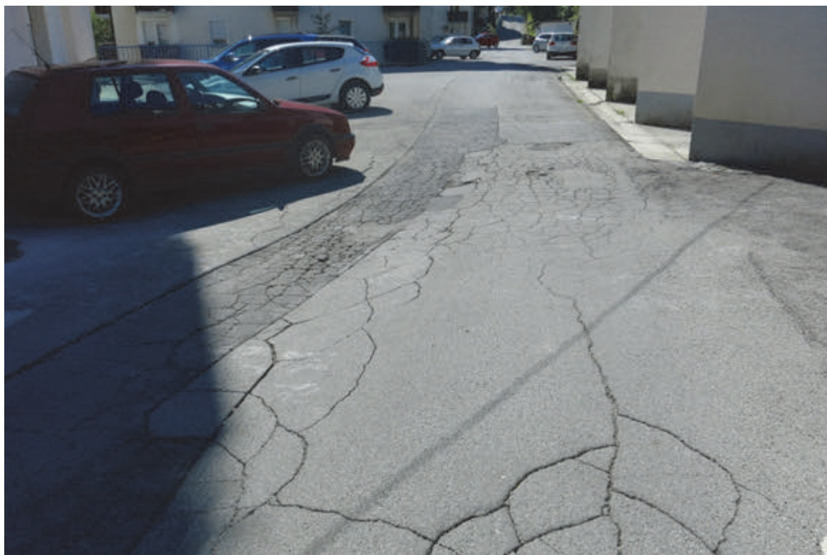
Slika 45: Razpoke v asfaltu zaradi slabše utrjene podlage na Beblerjevi ulici
