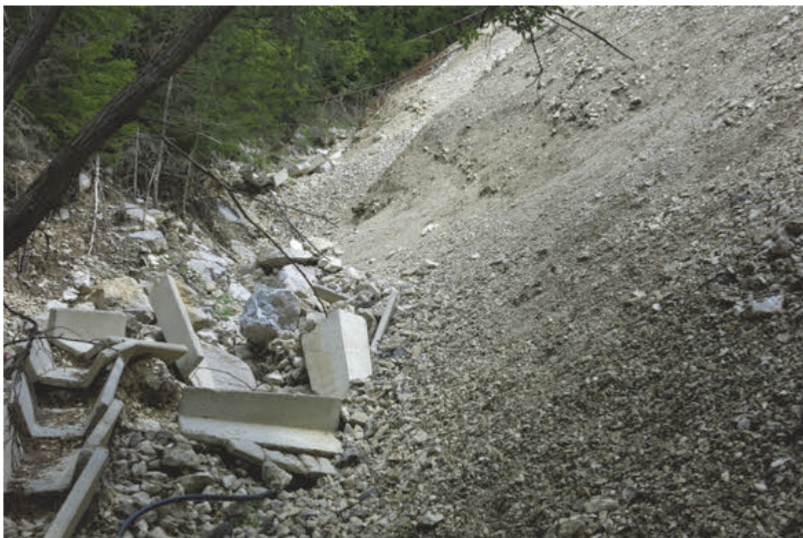
Slika 17: Porušene betonske kanalete na zahodnem delu odlagališča
