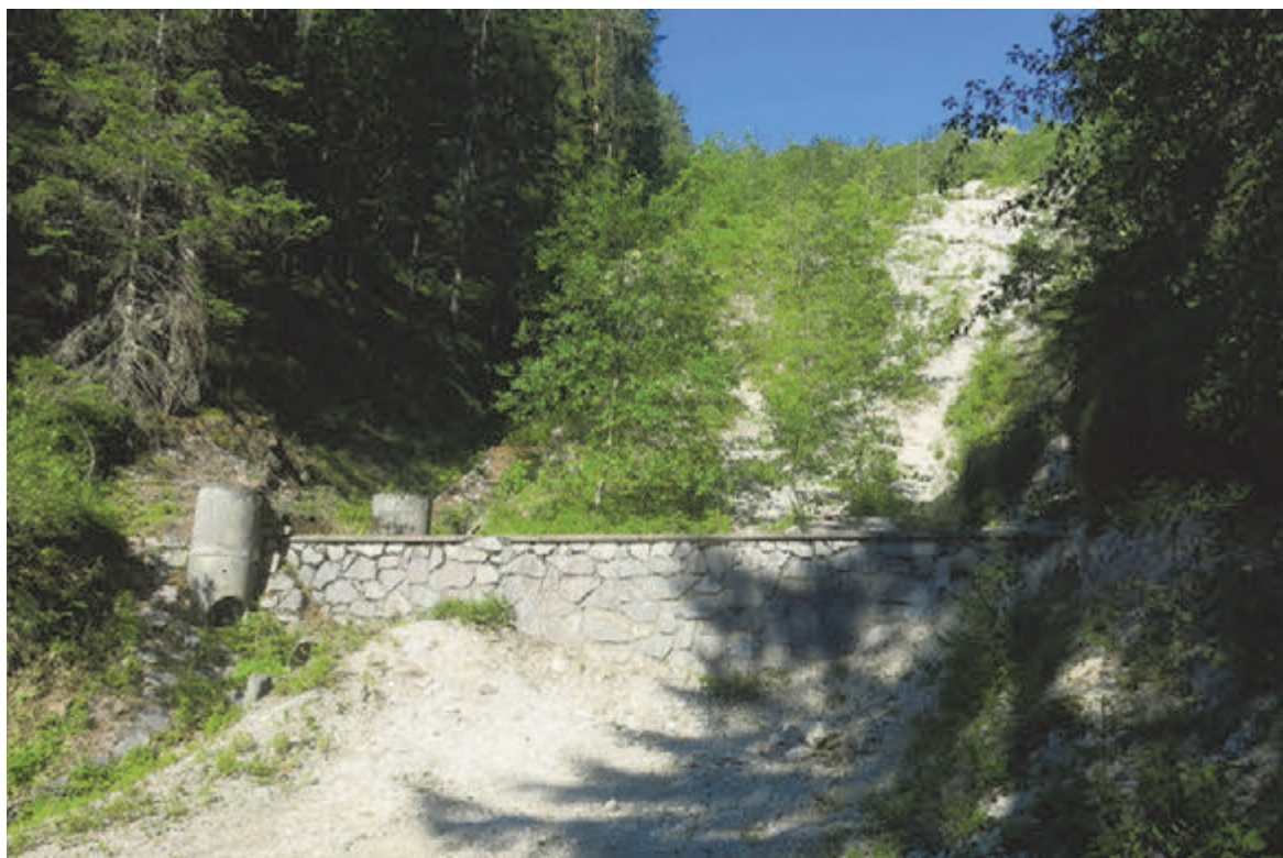
Slika 5: Lovilni zid z jaški za zbiranje vode v spodnjem delu odlagališča K-26/12
