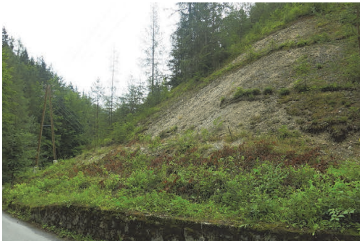
Slika 29: Razkrita brežina nad cesto
