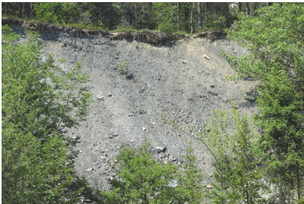
Slika 31: Strma brežina odlagališča K-19/9 Pleše-Čelo (9)
